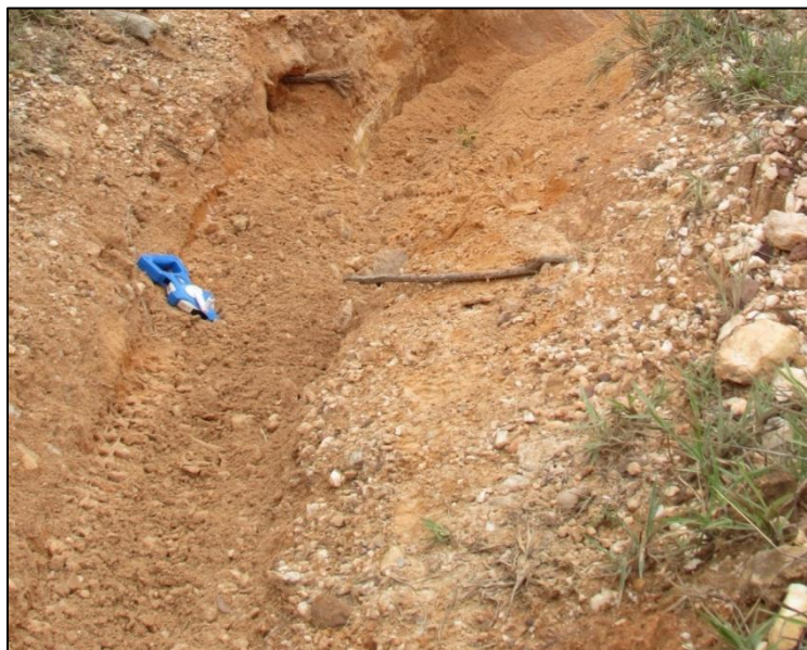
Figura 9. Erosão muito severa no ponto 23, com marcas de pneus de veículos off-road e rastros de gado e equinos. Acervo pessoal, 2023.
