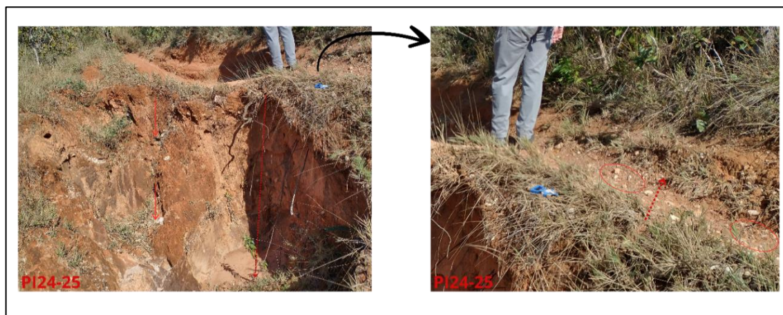
Figura 17. Ponto intermediário entre os pontos 24 e 25, com caminho estreito severamente erodido. Acervo pessoal, 2024..
